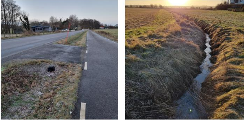
Figur 7 Längsgående svackdike samt öppet dike med utlopp mot Kattegatt.
